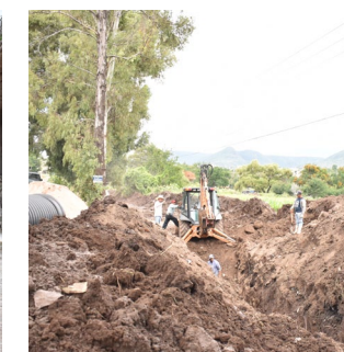
Drenaje pluvial en la Carretera Nacional en la cabecera municipal.
